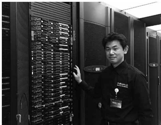
データセンター
